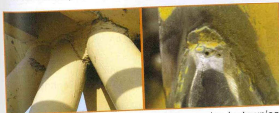
Rys. 2 Badania wizualne: a) węzłów suwnicy kratownicowej, b) wykryte pory w złączu spawanym
