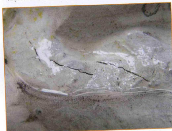
Rys. 4 Pęknięcie spoiny wykryte metodą MT
